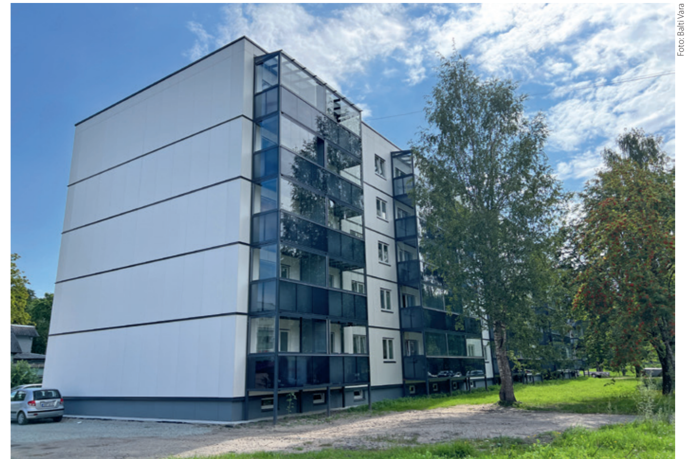
Kooli 7B renoveerimine Sindi linnas. Hübrüidtüüpi korterelamu tagumine osa kuulub 464-seeriasse, esiosa aga 111–121-seeriasse.
