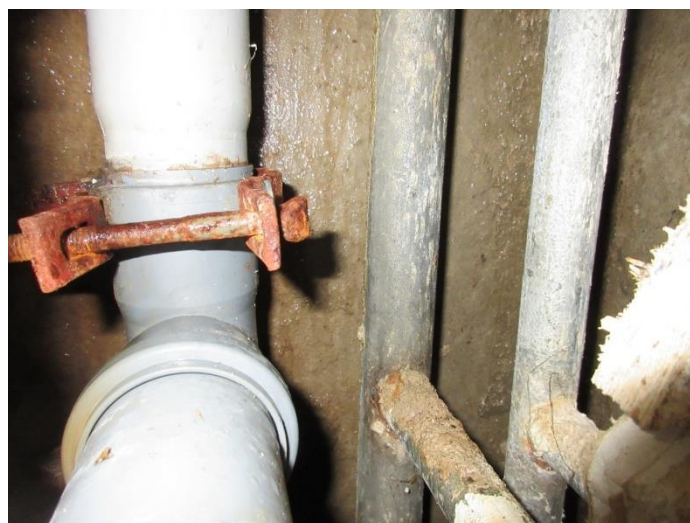
Torustiku kinnituse korrosioon. On tõenäoline, et kinnitusele esitatud nõuded pole täidetud. Kaunase pst 79, Tartu, 1995.
