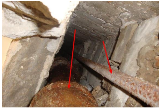
Väline korrosioon torustiku šahtis. Turu 11, Tartu, 1960-ndad.
