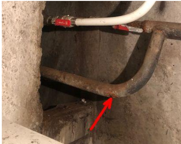
Punktkorrosiooni näide. Võnnu 11, Tartu, 1989.
